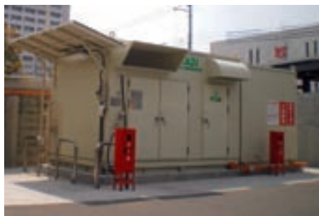
大阪ガス(株)兵庫導管部（神戸ポートアイランド内）に納入設置されたパッケージ型天然ガス充填設備
