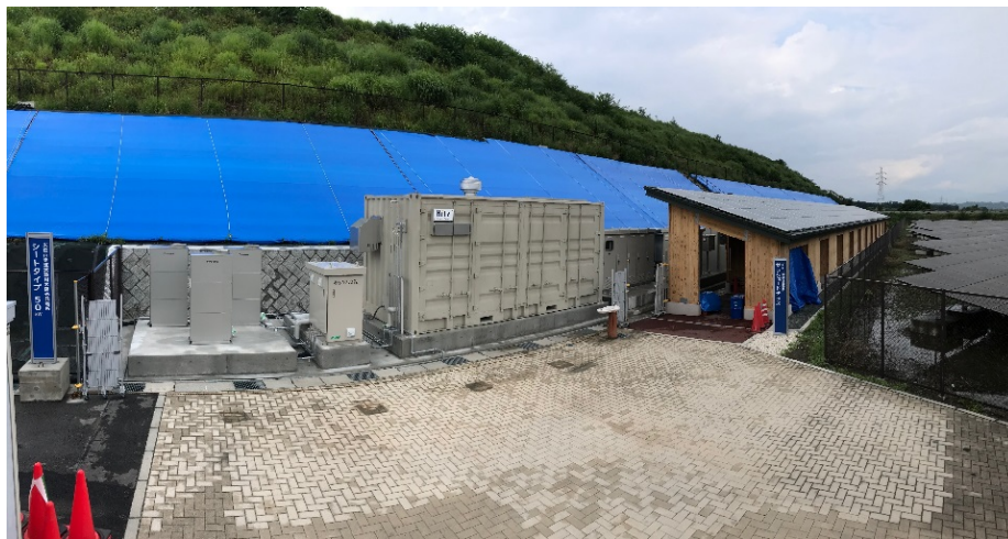
米倉山 水電解実証設備エリア
